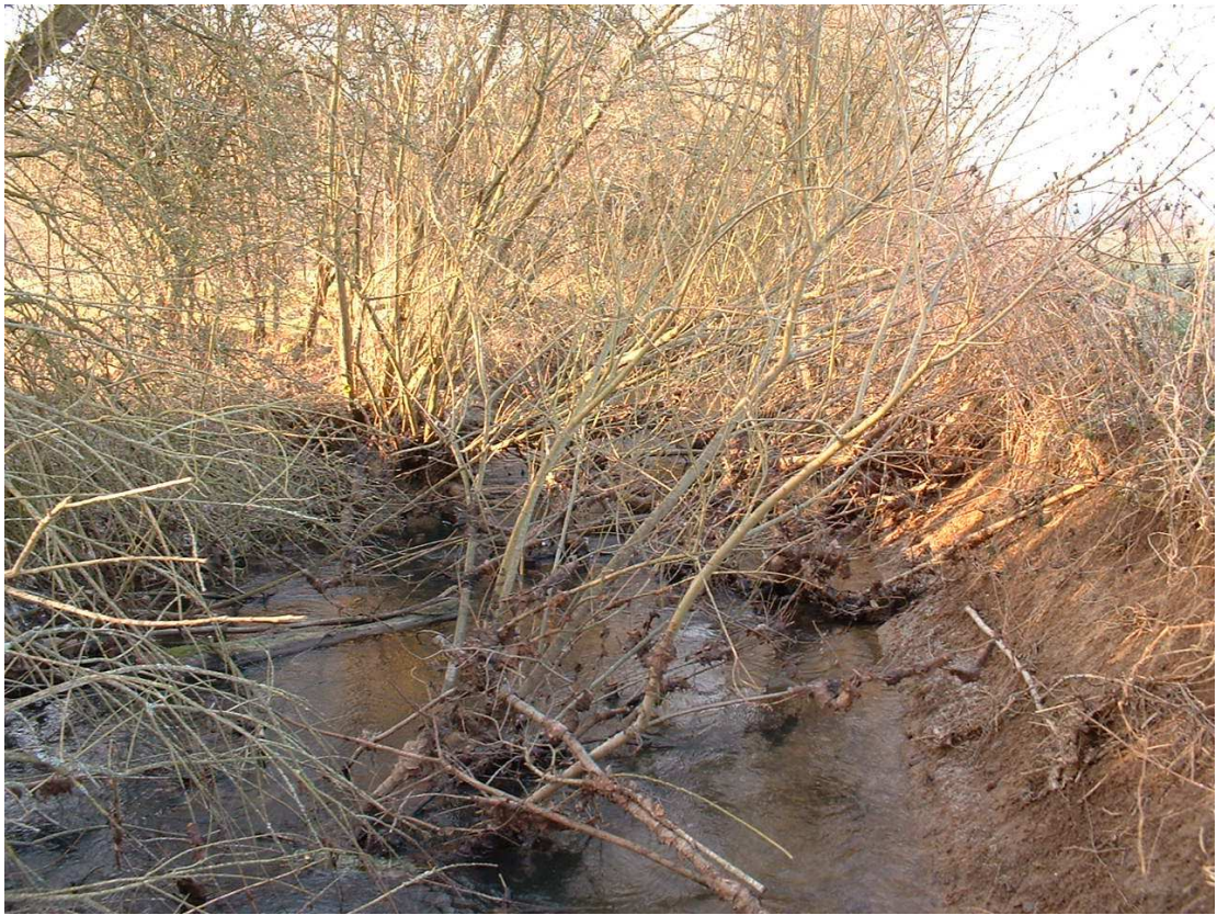
Avant travaux : lit envahi par saule marsault
